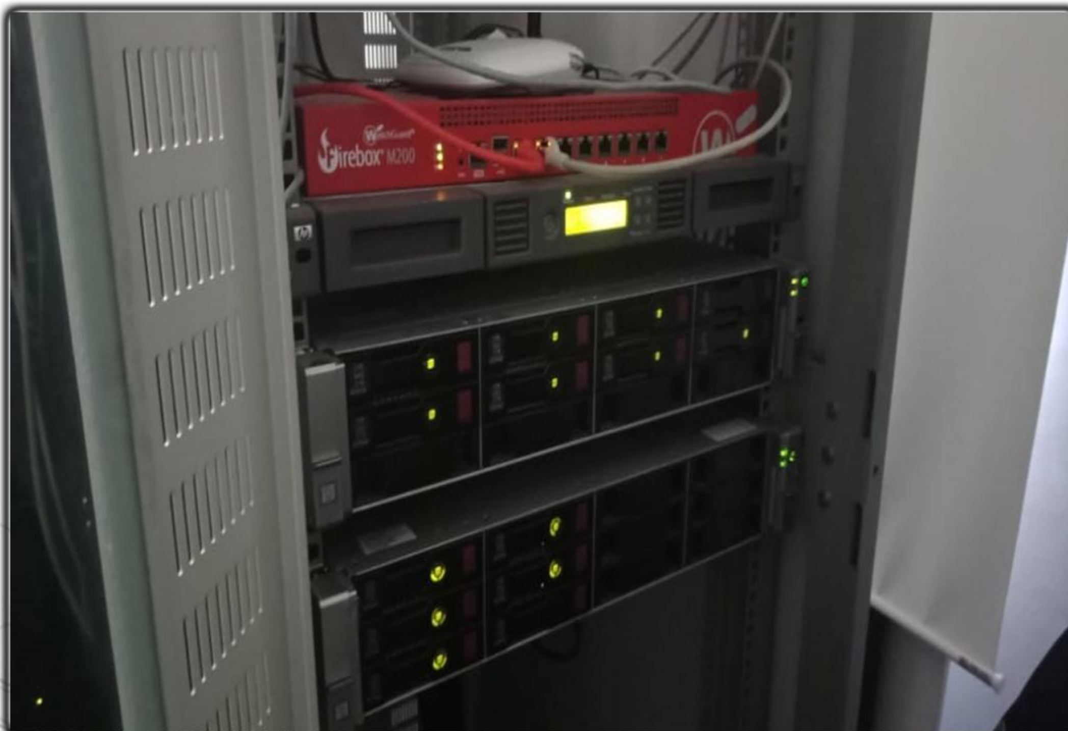
Ruang server Schutz
